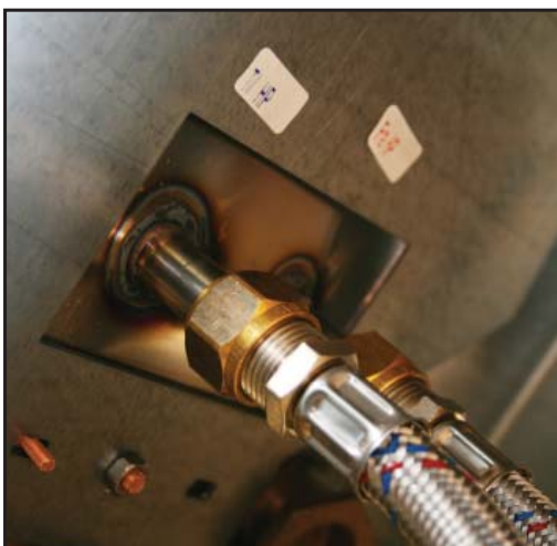
Tilkobling av slanger under varmtvannsbereder. Blå - KV til innedel, Rød - VV fra innedel
