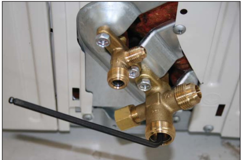
Servicenipel og stengeventiler for utedel.
