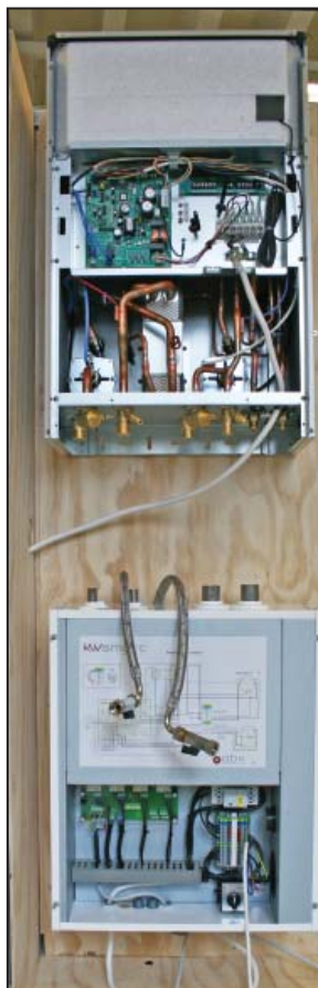
Innedel og Modul1 montert. Slanger til VVB er ført bak Modul1.
