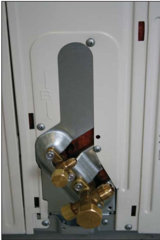
Rørtilkopling på utedel med servicekran.
