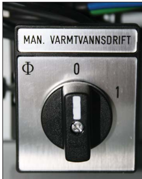
Bryter for varmtvannsbereeder skal stå i 0 når VP er aktivert. Brukes kun til nøddrift av VVB når VP er ute av drift.
