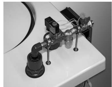
Niveau- und Pumpensteuerung, mit Magnetventil
